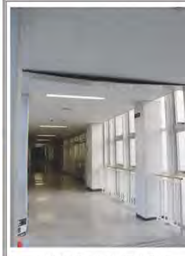
ゆがんでしまった天井部分
