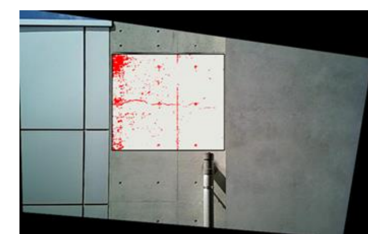
(d-2) C棟2階壁面 (オルソ画像によるひび割れ調査画像)
