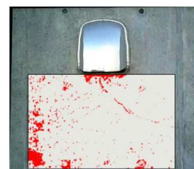
(c-2) 新体育館1階上方壁面 (オルソ画像によるひび割れ調査画像)
